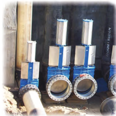
Instalación en la cámara de mezcla
